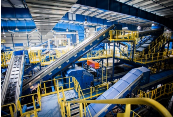
Ilustracja I.4. Zautomatyzowana część mechaniczna instalacji MBP
