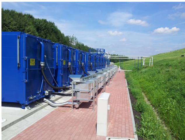
Ilustracja I.5. Kompostownia kontenerowa dla odpadów zielonych w ZSGOK
